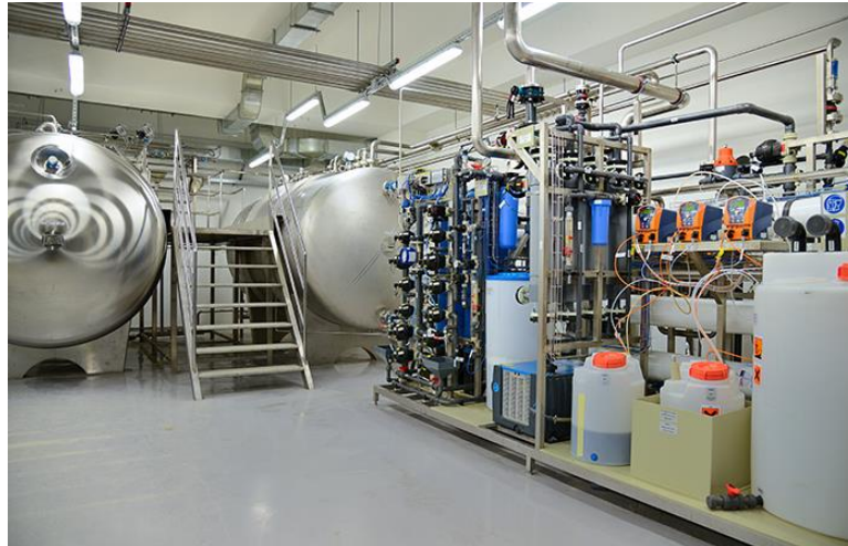
Slika 7. Sustav za pročišćavanje otpadne vode u hotelima 22
