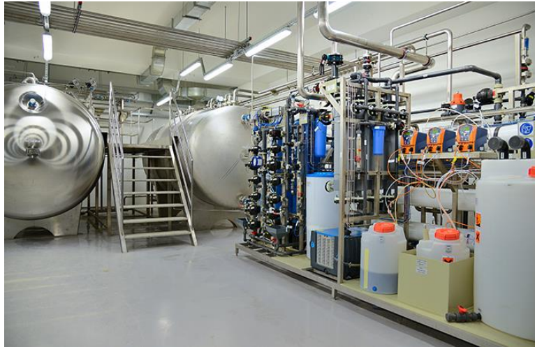
Slika 7. Sustav za pročišćavanje otpadne vode u hotelima 22
